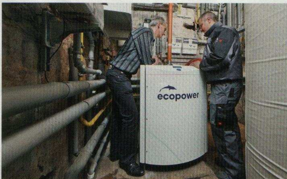
Bild 1: Sébastien Guesnet (links), Eigentümer der artgenossen GmbH, und Cyrus Pakulat, Geschäftsführer der PS-Gebäudetechnik, sind mit der Mini-BHKW-Lösung zur Energie- und Wärmeversorgung des Gebäudes – bei einer Kosteneinsparungen von rund 3000 Euro jährlich – sehr zufrieden.
